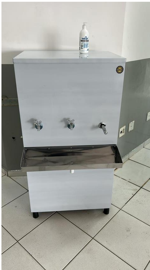
Figura 13. Novos bebedouros instalados dentro da Unidade de Passos com maior capacidade de armazenamento.
